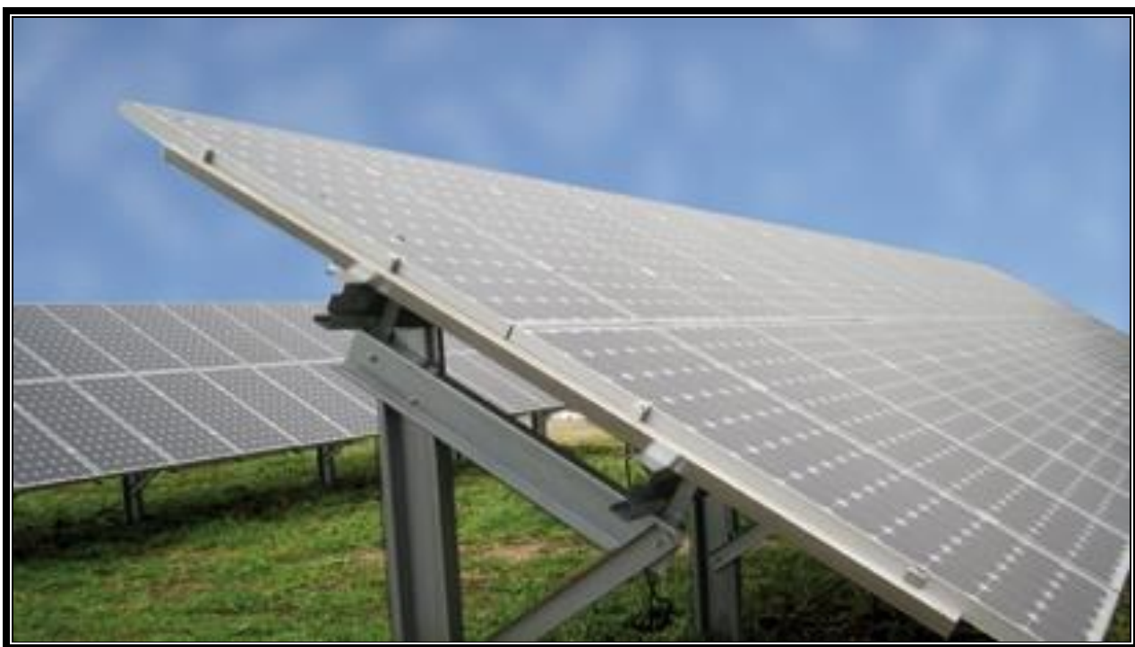
Figura 7 – Moduli su strutture fisse
