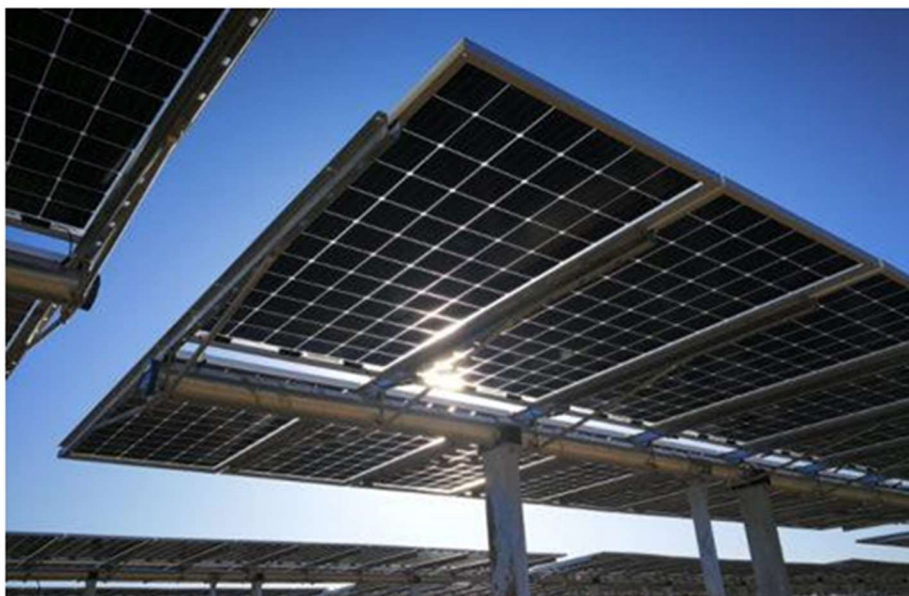
Figura 2.2: Particolare strutture di sostegno moduli
