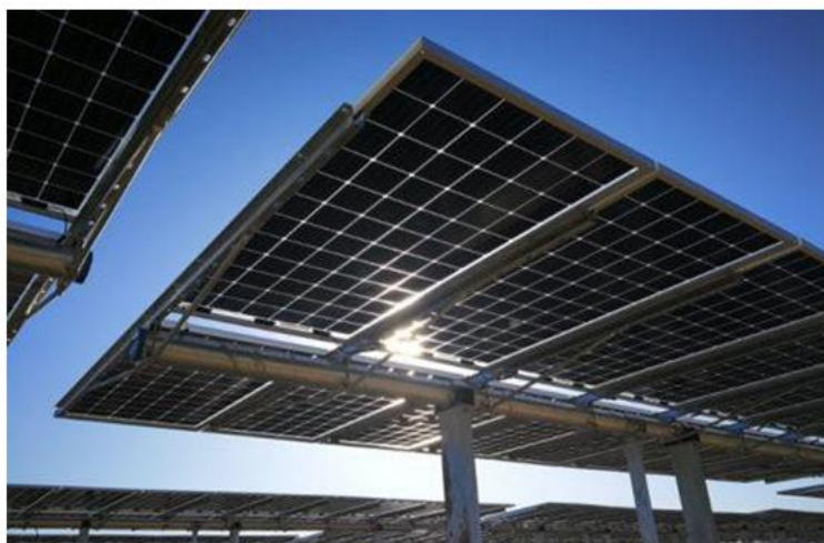
Figura 3.5: Particolare strutture di sostegno moduli
