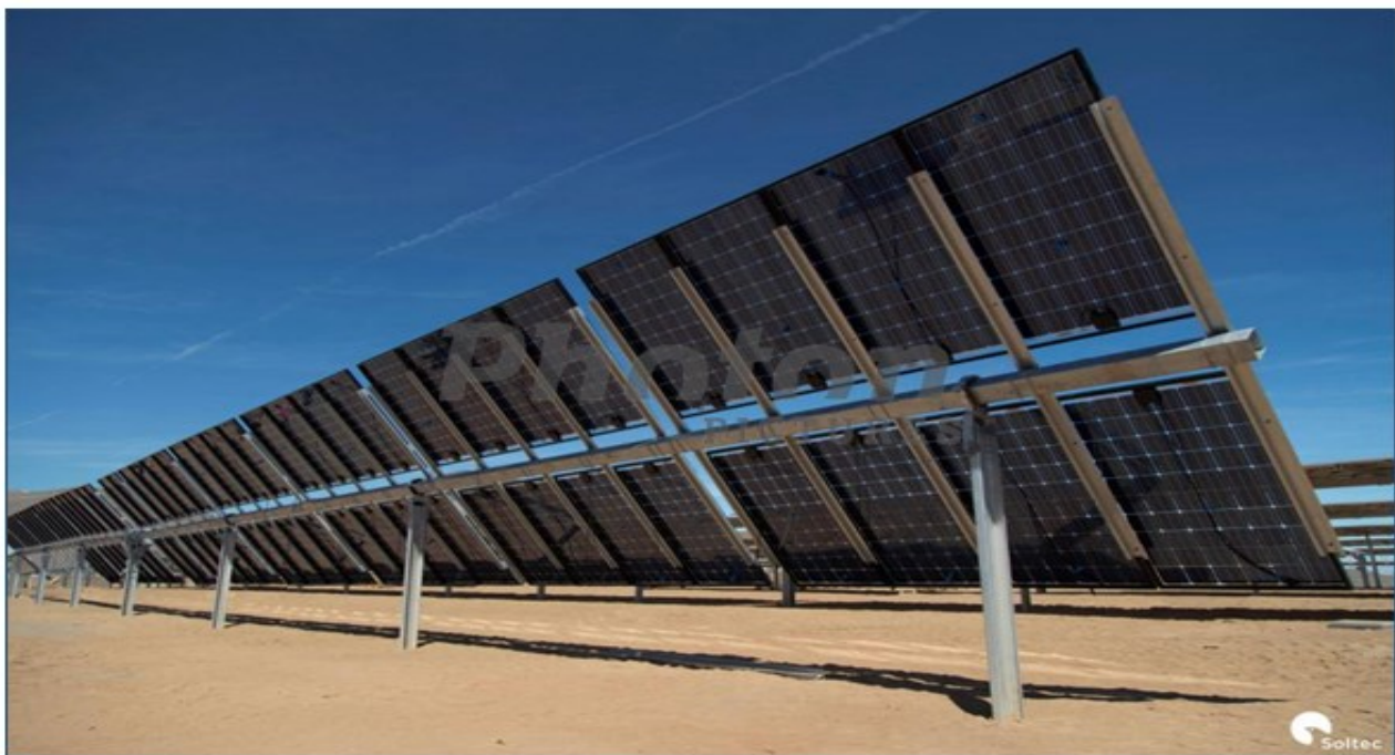
Figura 5 – Impianto con strutture mobili ad inseguimento monoassiali
