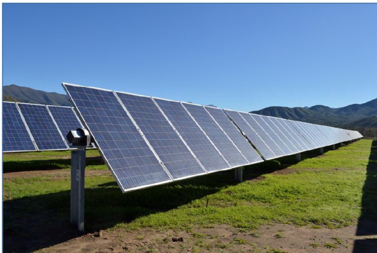
Figura 3-5: esempio campo fotovoltaico con moduli montati su inseguitore mono assiale
