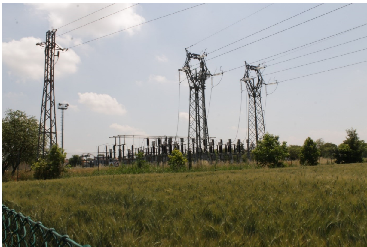
Figura 5-10: punto di vista 13- Stazione Elettrica esistente di Mezzolara di Budrio
