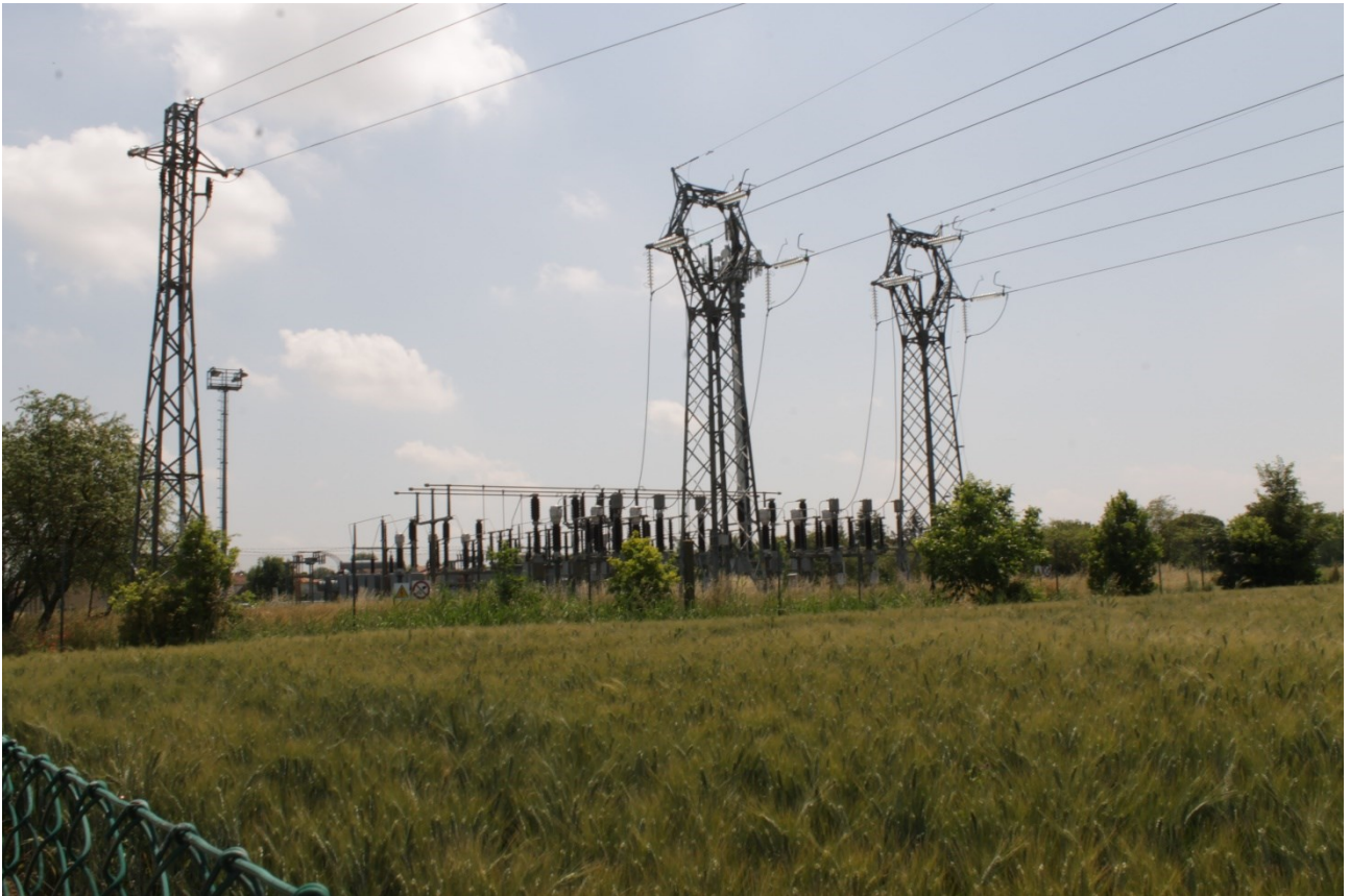
VISTA 13 – Stazione Elettrica di Mezzolara di Budrio
