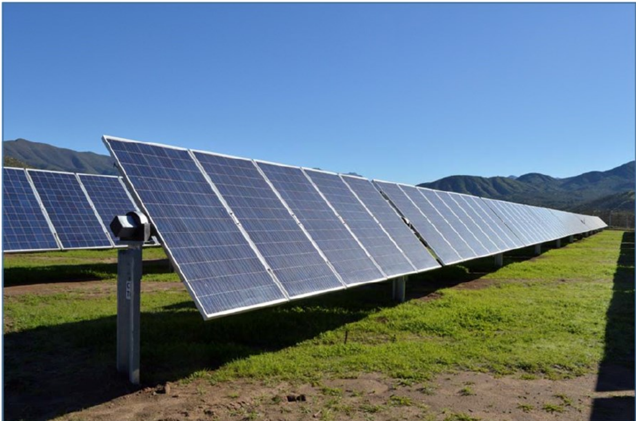
Figura 2-4: esempio campo fotovoltaico con moduli montati su inseguitore mono assiale
