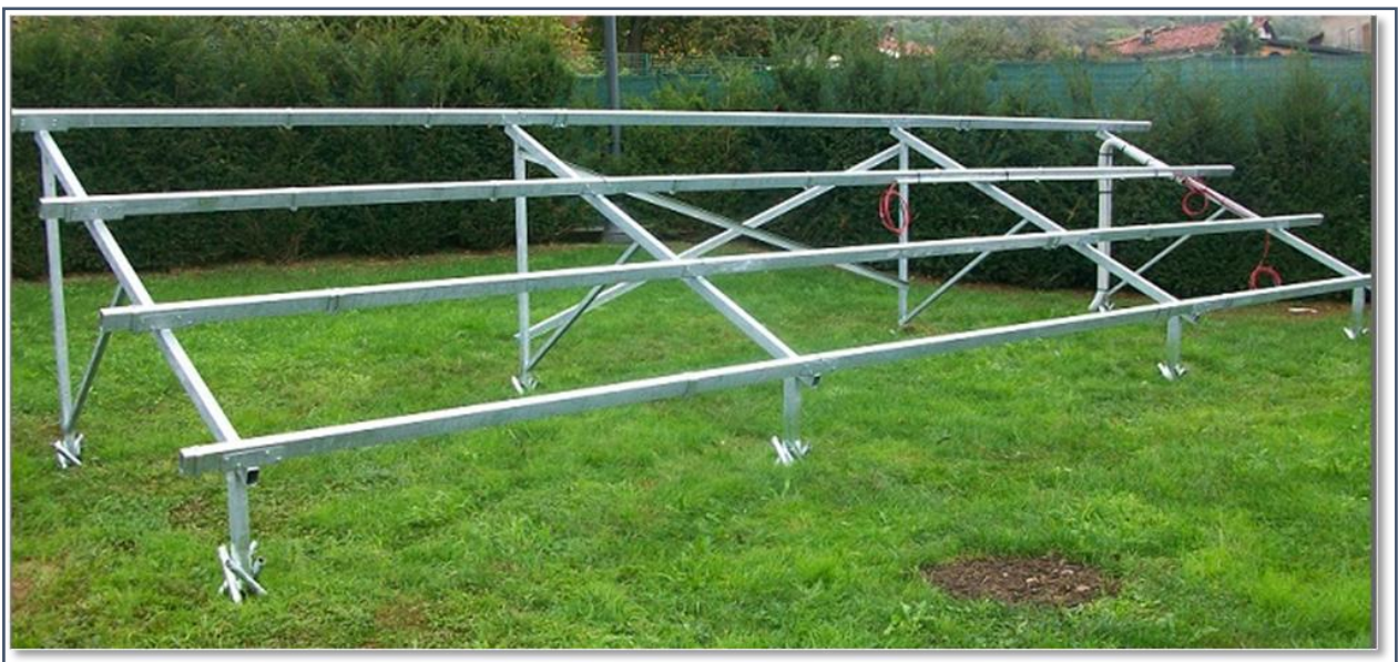
VISTA DELLE STRUTTURE METALLICHE DI SUPPORTO DEI MODULI FOTOVOLTAICI
