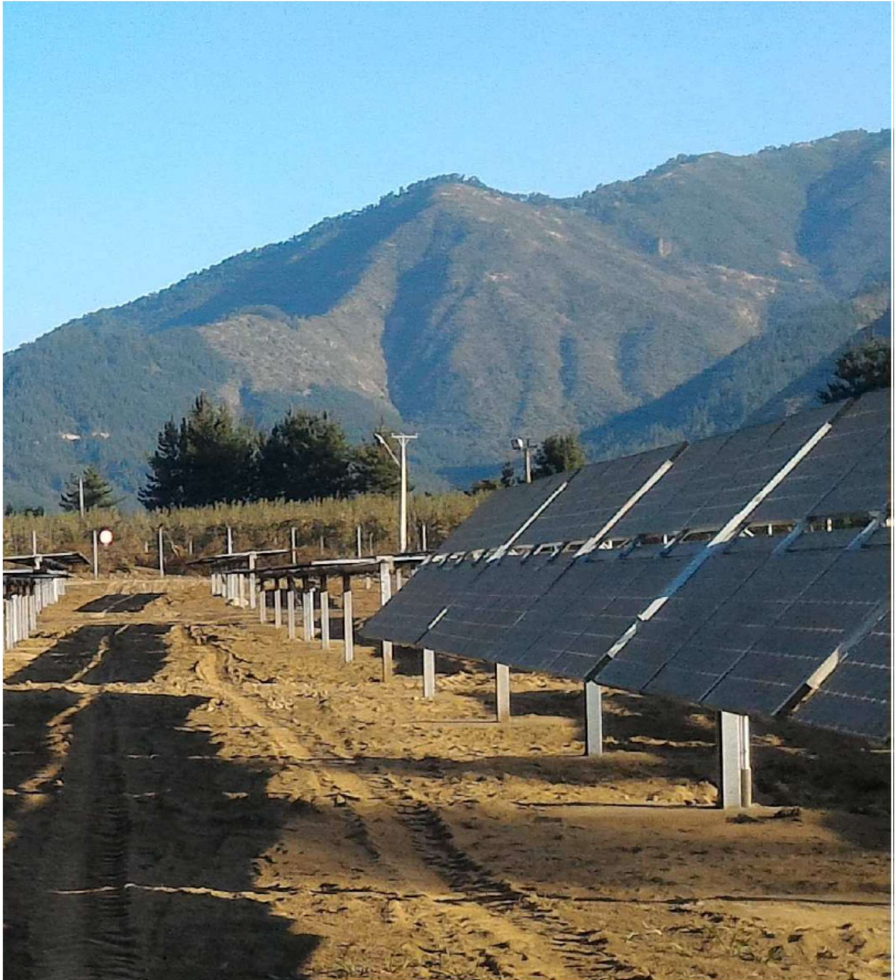
Fig. 6 Disposizione dei moduli fotovoltaici sui tracker
