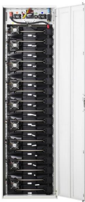
Figura 8.3-3 Esempio rack batterie
