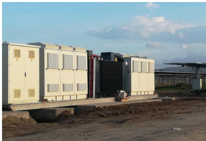
Figura 8.3-8 Esempio skid conversione
