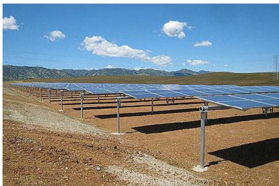
Figura 3.1-3 Inseguitori di Rollio
