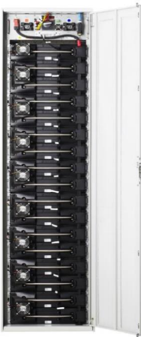
Figura 8.3-3 Esempio rack batterie
