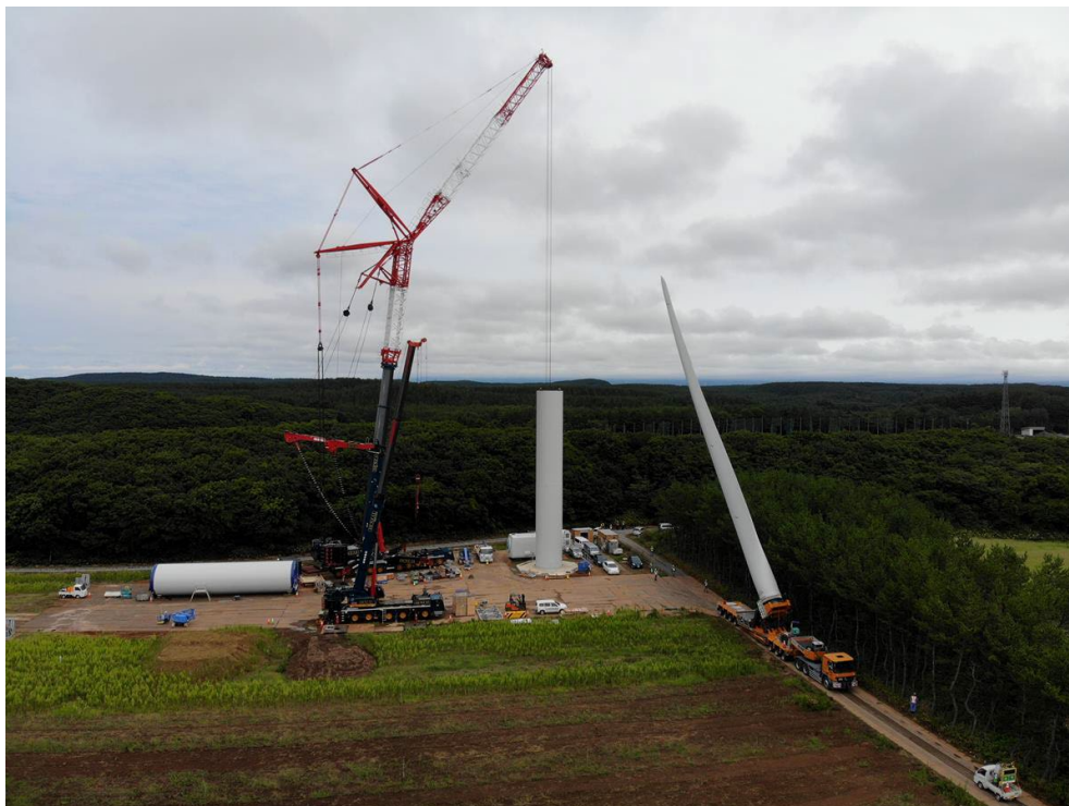
Figura 3 – Fase di montaggio dell'aerogeneratore con torre principale in azione e trasporto della pala con sistema blade lifter, per ridurre la lunghezza dei mezzi di rimorchio.
