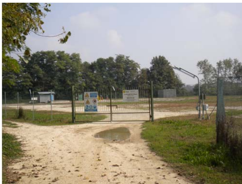
Figura 8.1.a – Pozzi Ripalta 27 e 61: vista presso l'ingresso dell'impianto
