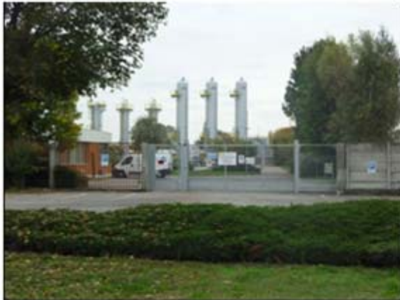
1) Ingresso dell'impianto di trattamento
