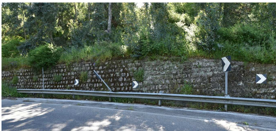
La zona a monte del rilevato stradale caratterizzata da pericolosità geomorfologica moderata (Hg2) è contraddistinta da vegetazione fitta senza segni di dissesti recenti
