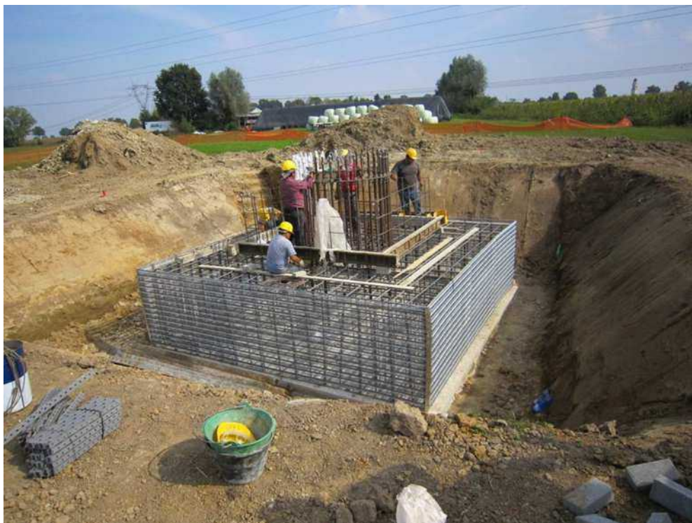
Realizzazione di fondazione superficiale tipo plinto a monoblocco per un sostegno monostelo. Nell'immagine si può osservare la fase di cassetatura (immagine d'archivio)
