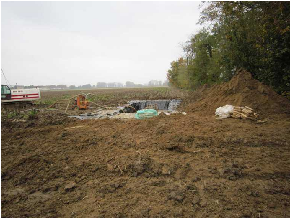
Allestimento di un impianto a circuito chiuso per la realizzazione di pali trivellati mediante l'utilizzo di fanghi bentonitici. In questa immagine si osservano la vasca impermeabilizzata per la decantazione del fango, la pompa di rilancio del fango verso il foro e l'area di deposito dei sacchi contenenti la bentonite (immagine d'archivio)
