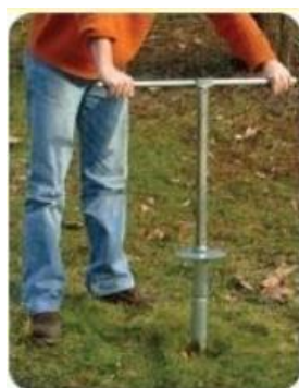
Messa in opera del supporto, tramite apposita chiave, dopo opportuna verifica della verticalità.
