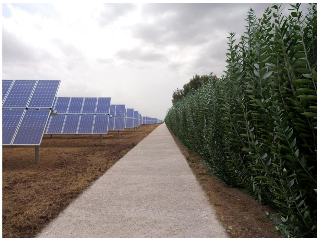
Figura 36 - - PV 11 Punto di vista interno all'area di impianto in progetto: particolare area interna, pannelli, strutture tracker, interventi di mitigazione con vegetazione autoctona
