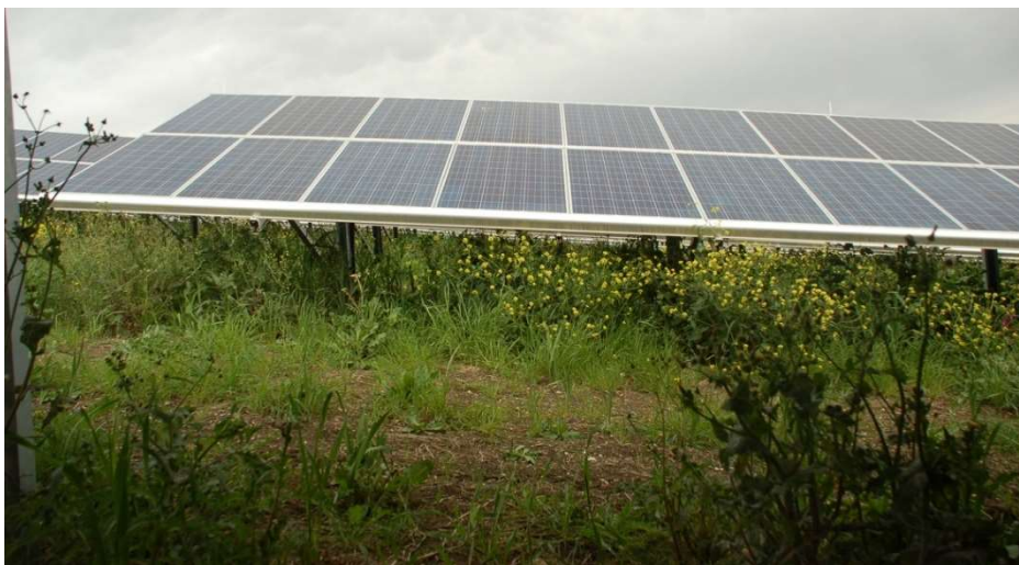
Figura 19 - Caso studio Parco Fotovoltaico "Villalba di Gesù" da 5 MW (Foto G. Filiberto)
