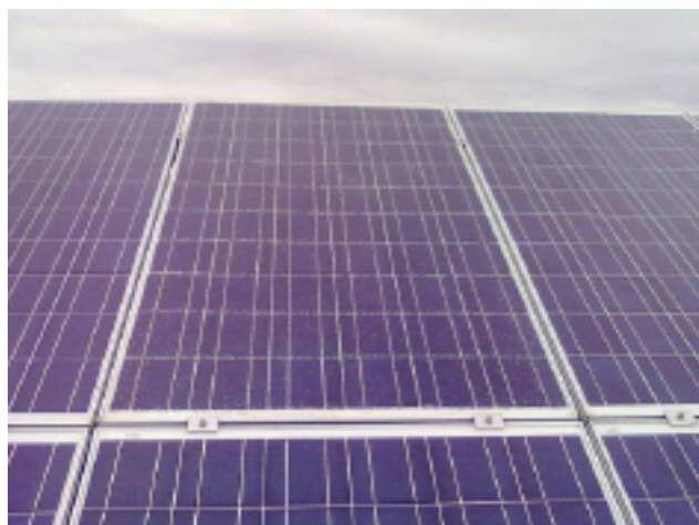
Tavola n. 21: Modulo con superficie compromessa
