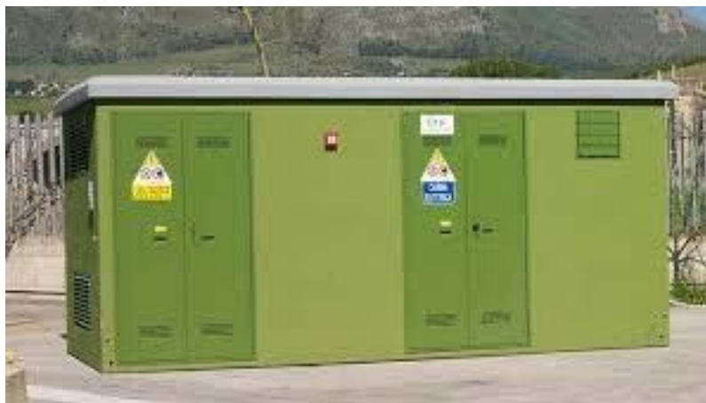
Cabina elettrica monolitica in Ral 6002
