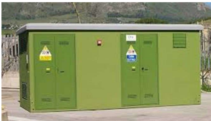
Figura 10: Cabina prefabbricata tipica utilizzata in progetto
