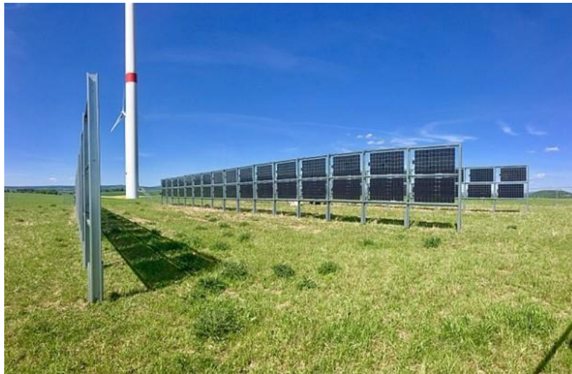
Figura 20: Esempio di Agrovoltaco con pannelli bifacciali installati in verticale
