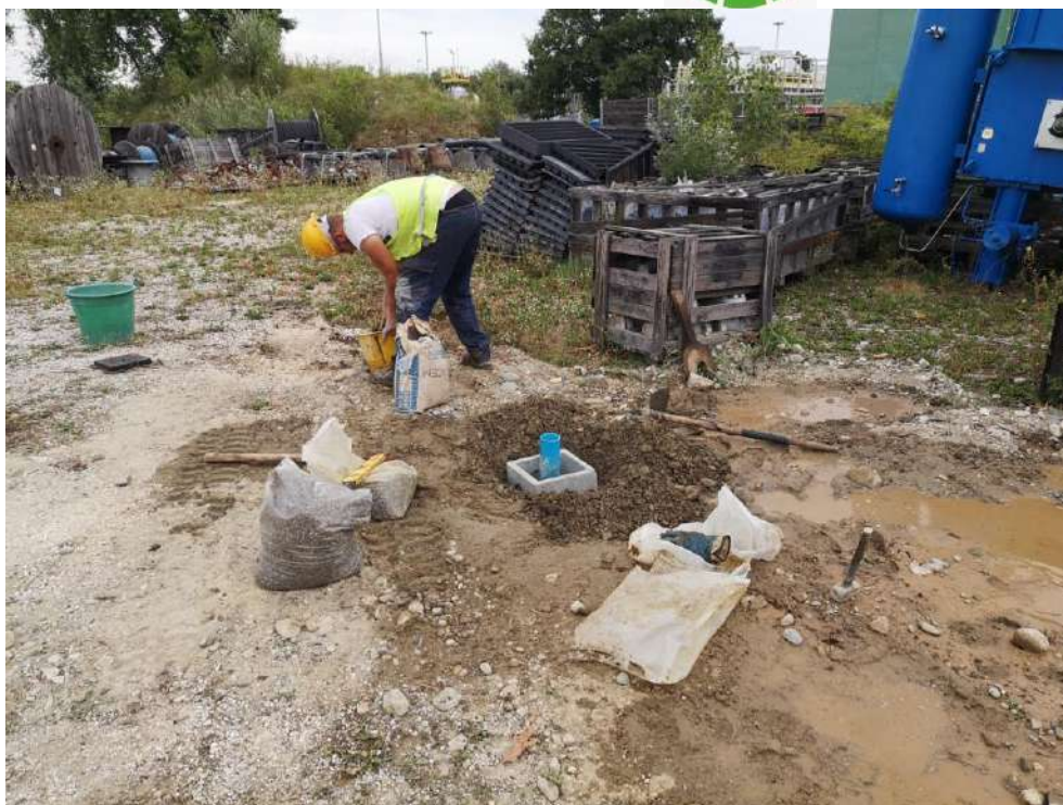
Foto 3 – Pozzetto aperto con piezometro
