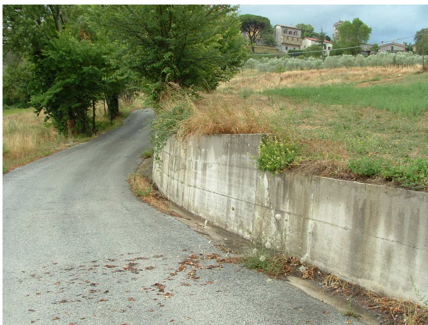
Figura 27 – Aspetto del piede della frana in corrispondenza della strada bassa: non si segnalano lesioni al muretto di contenimento della scarpata.
