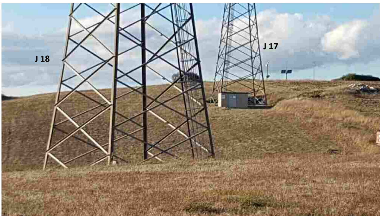
Foto 6 - Turbina J 18 e turbina J 17 , da dismettere (Comune di San Marco dei Cavoti)
