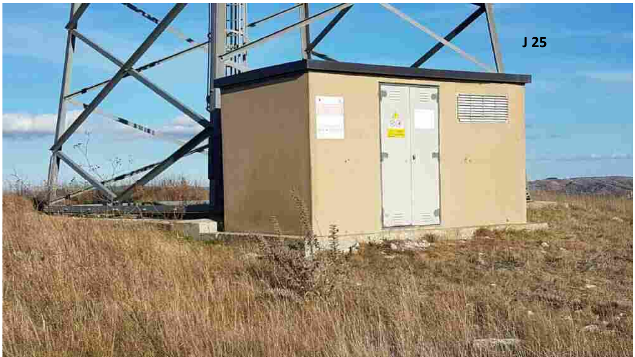
Foto 11 – Particolare area basale Turbina J 25 da dismettere (Comune di San Marco dei Cavoti)
