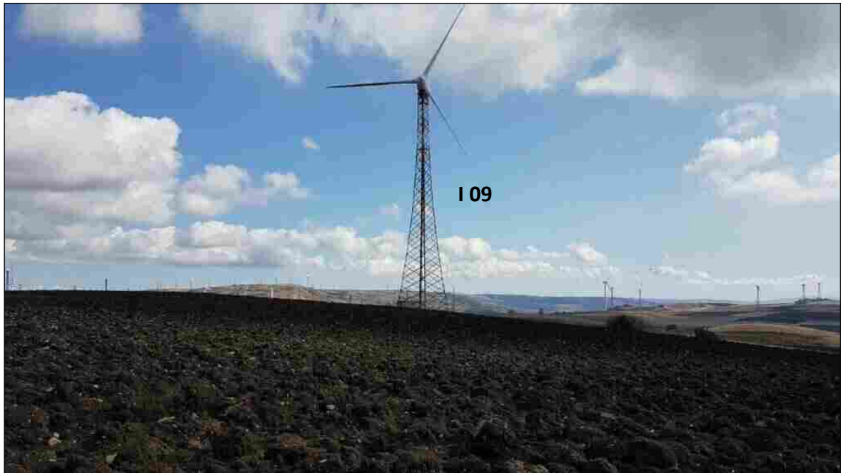
Foto 21 – Turbina I 09 , da dismettere (Comune di San Giorgio la Molara)
