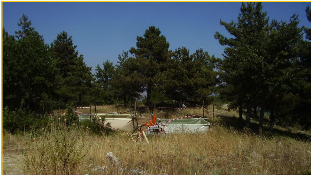
Impianto di stoccaggio e pompaggio acqua sondaggio S10
