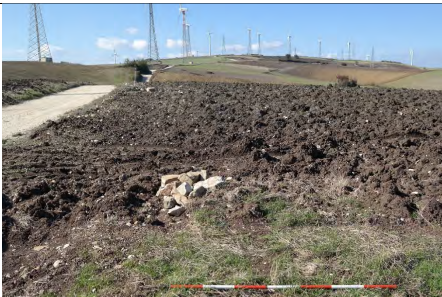
Foto 13: cavidotto in strada comunale Montefalcone nei pressi di SGM01. Vista da sud
