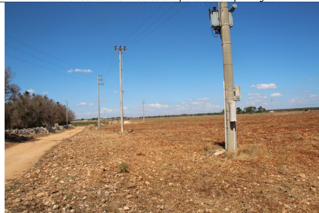
Punto scatto n.36: Linee elettriche aeree MT
