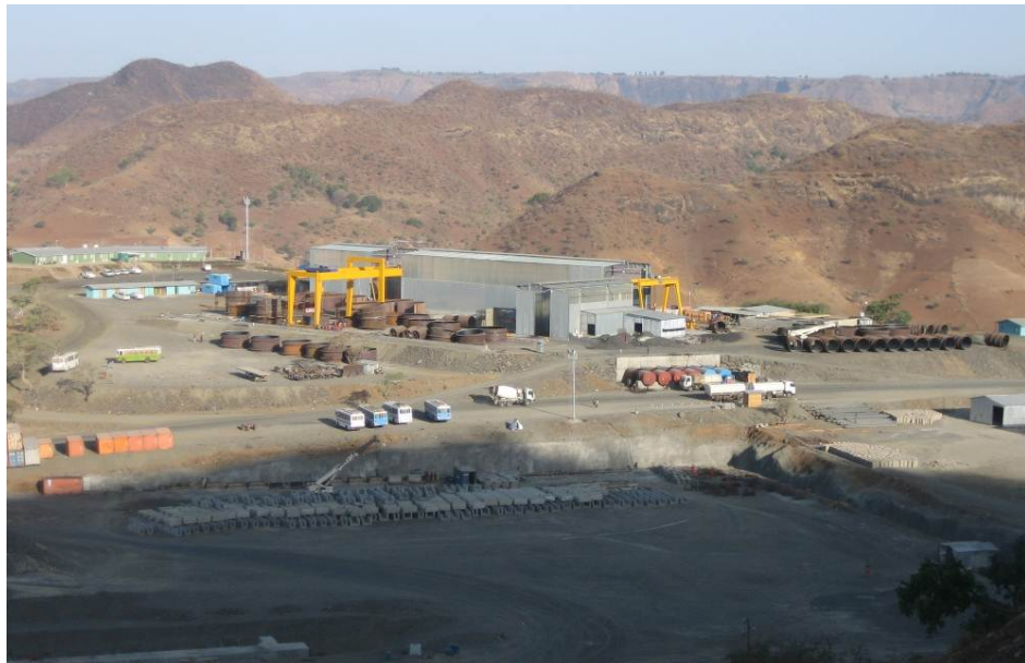
Figura 3.1: Impianto Fabbricazione Virole
