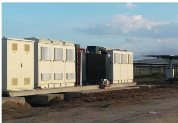
Esempio skid conversione
