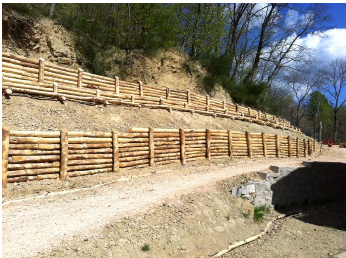
Foto 8.1.1/A – Palizzate di contenimento in legname
