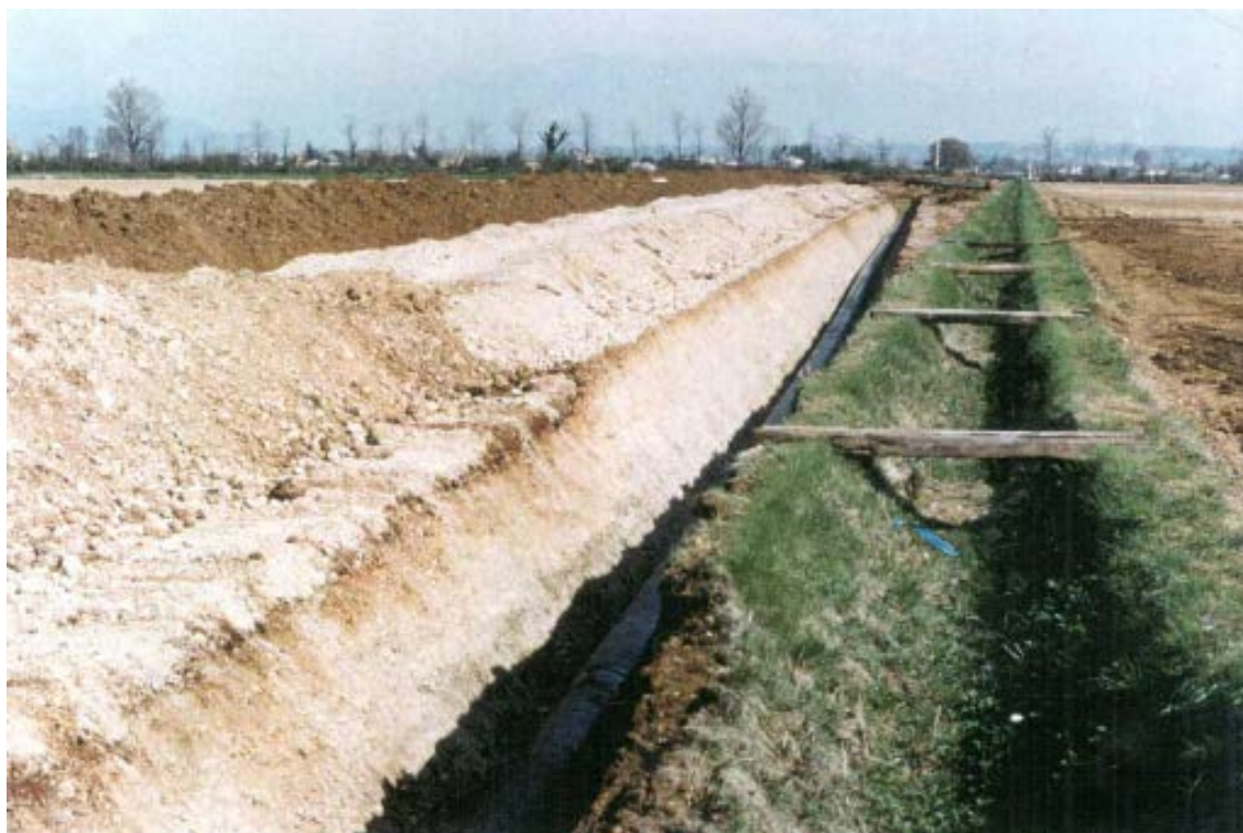
Foto 7.1.8/B - Tratto di condotta posata, con accantonamento dello strato humico separato dal materiale di scavo della trincea
