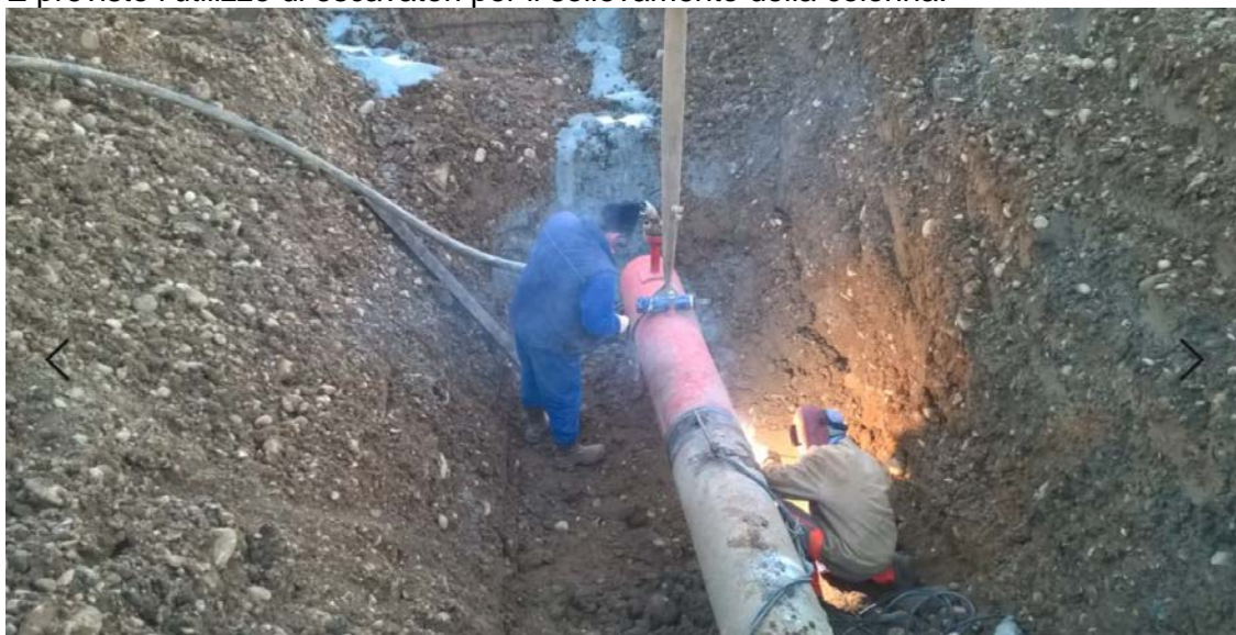
Foto 7.2.4/A – Sezionamento condotta
