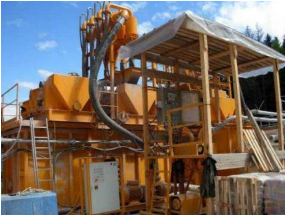
Foto 7.1.11/C - Sistema di disidratazione
