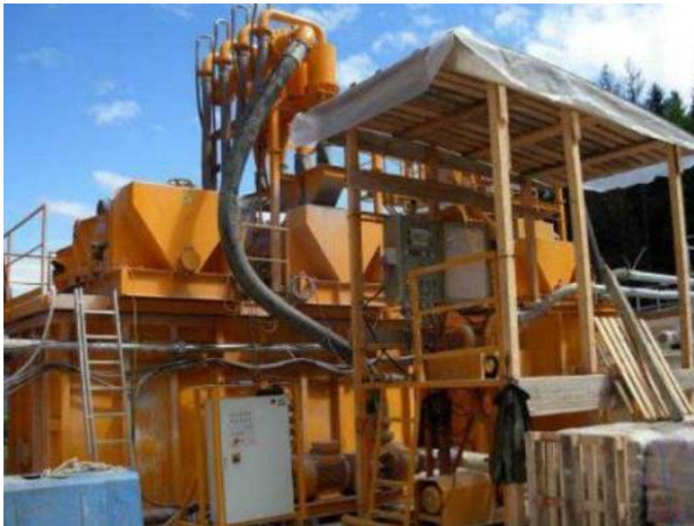
Foto 3.2.2/D Sistema di disidratazione
