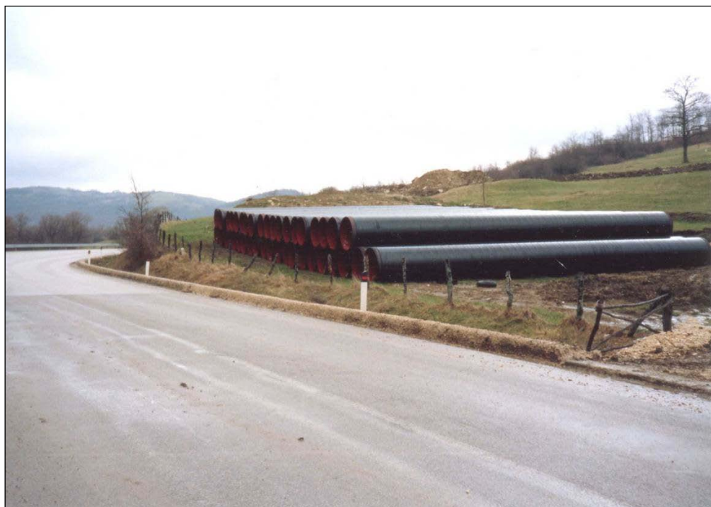
Foto 3.2.1/A Esempio di piazzola di accatastamento tubazioni
