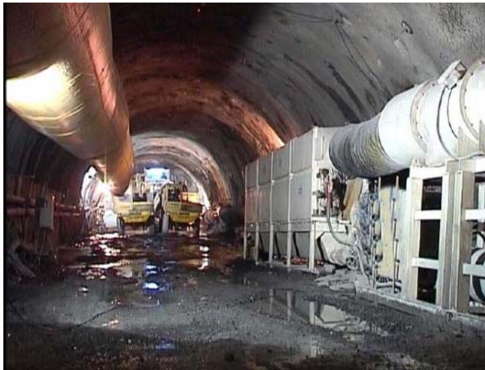
Figura 6.3: Vista del Sistema di Ventilazione e del Depolveratore in uno Scavo di Tunnel Ferroviario (Jeur e Pathak, 2008)
