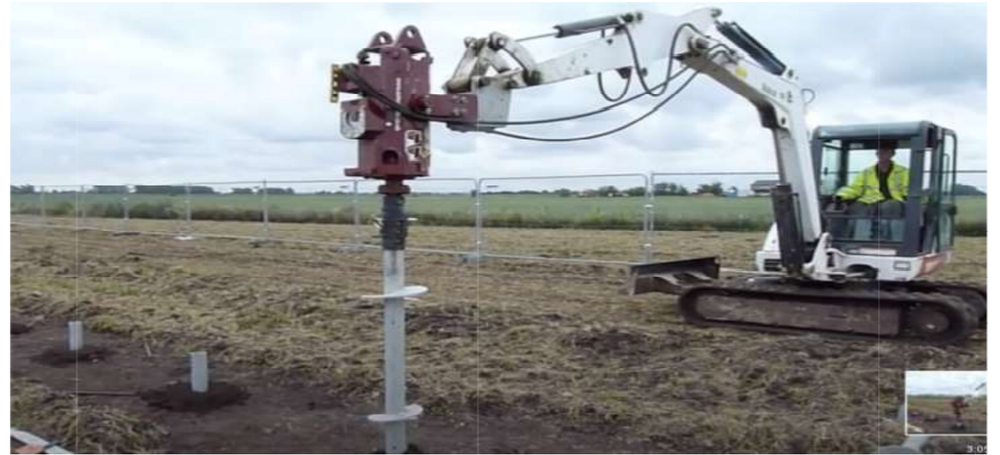
L'IMPIANTO DI PROGETTO - MACCHINA ESCAVATRICE PER IL FISSAGGIO DEI SUPPORTI DELLE STRUTTURE
