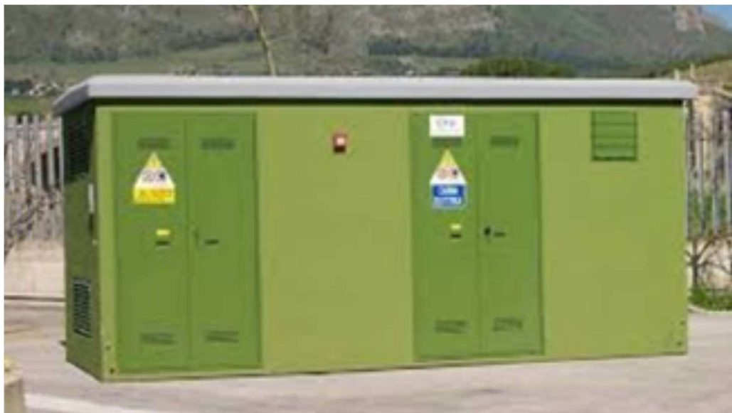
Figura 19: Tipico cabina prefabbricata
