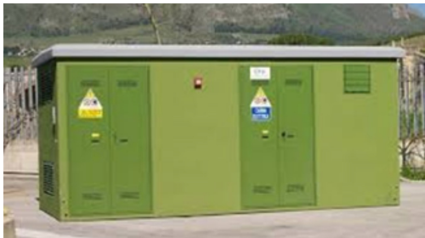
Figura 14: Tipico cabina prefabbricata
