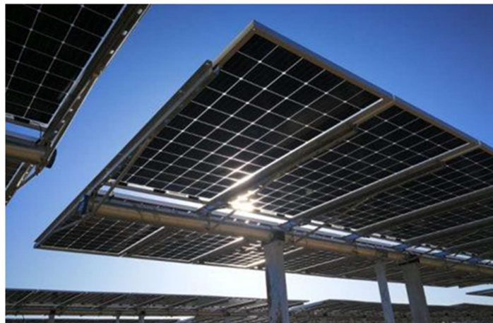
Figura 3.5: Particolare strutture di sostegno moduli
