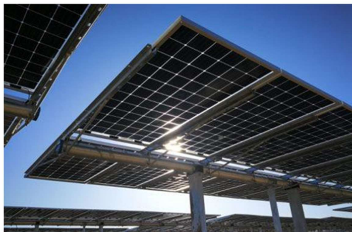
Figura 2.6: Particolare strutture di sostegno moduli
