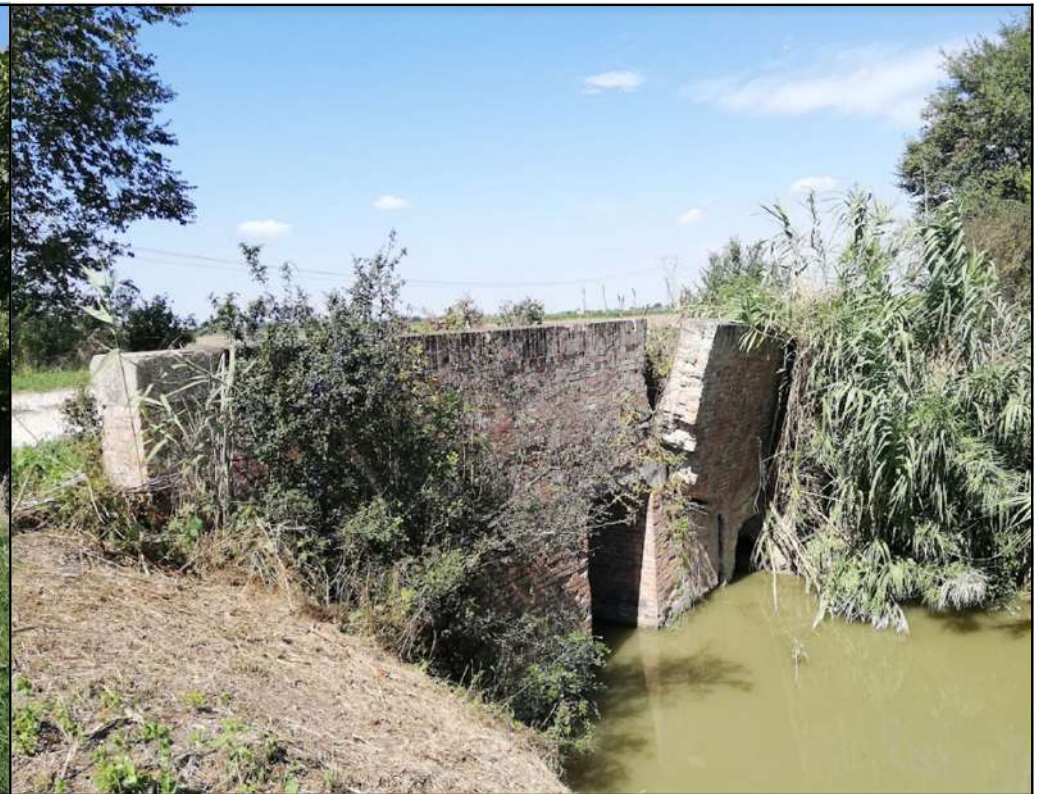
Ponte non idoneo lato nord
