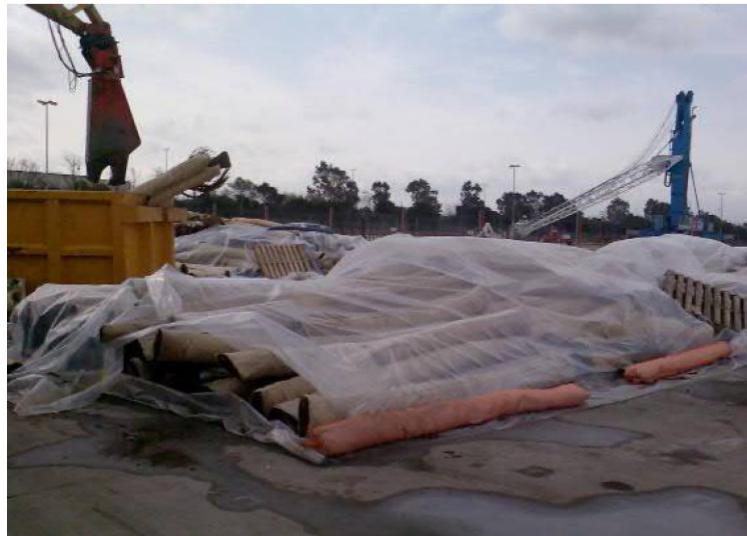
Figura 3-8: Spezzoni riser 6" tagliati e lasciati a sgocciolare negli appositi vasconi (a sinistra). Copertura spezzoni di risers con telo impermeabile (a destra)
