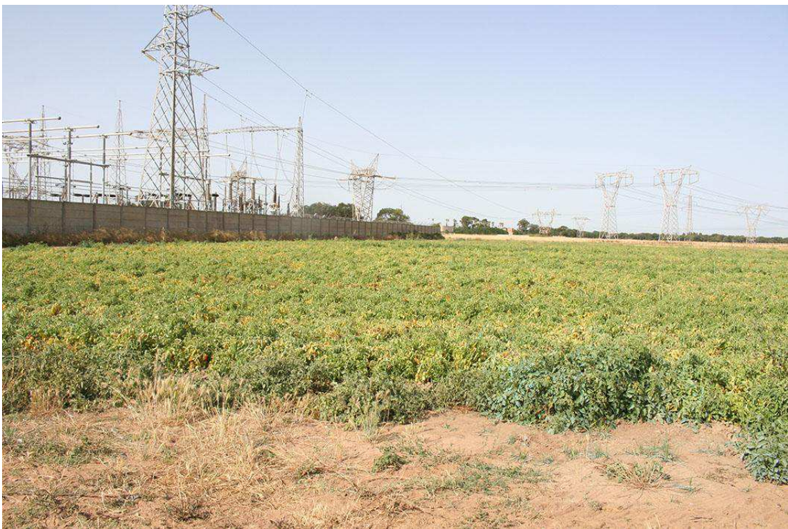
60 – Brindisi (BR), UR 10 panoramica del segmento di cavidotto in direzione O presso la Stazione elettrica Terna
