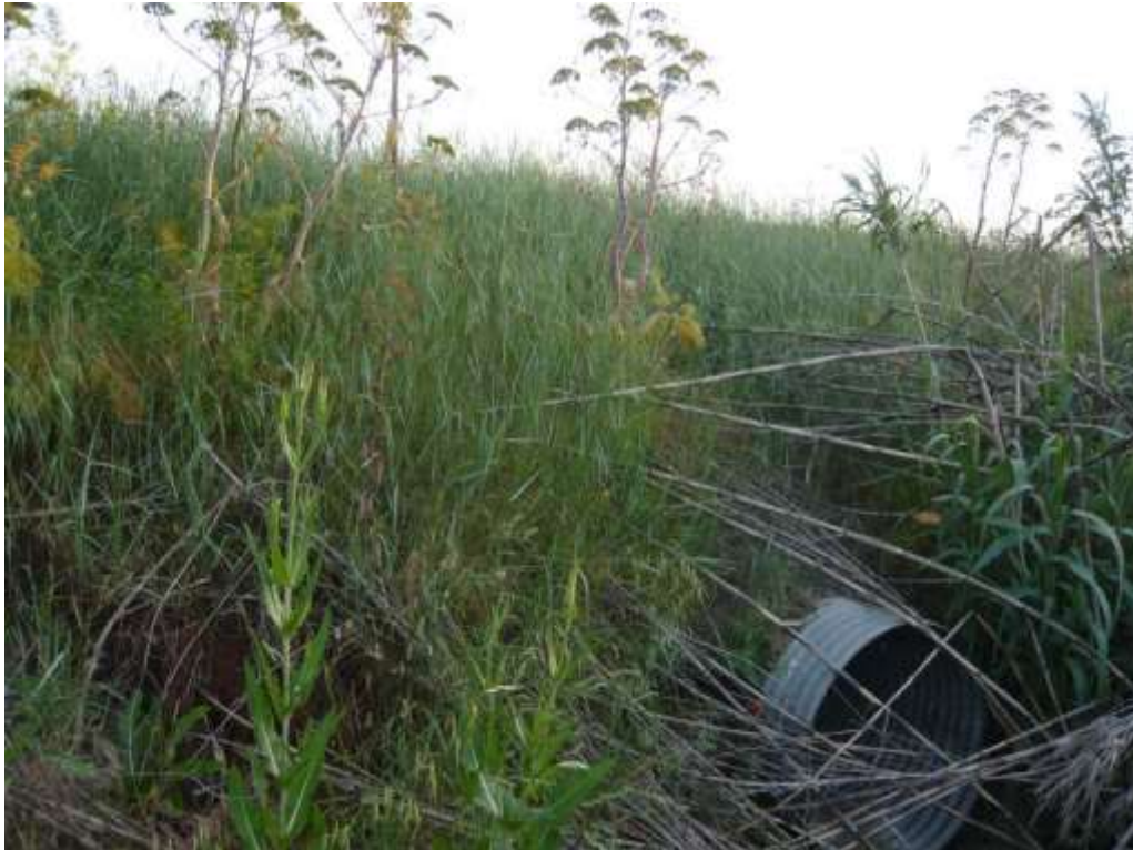
Foto 6.1 – Vista della parte alta del bacino, nei pressi della sezione 43 del Reticolo A1 , si può notare il tombino che attraversa il rilevato stradale.
