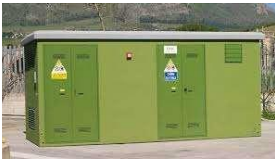
Figura 12: Cabina prefabbricata tipica utilizzata in progetto
