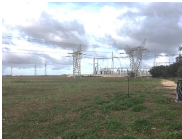
Fig. 12 – Punto di misura B
