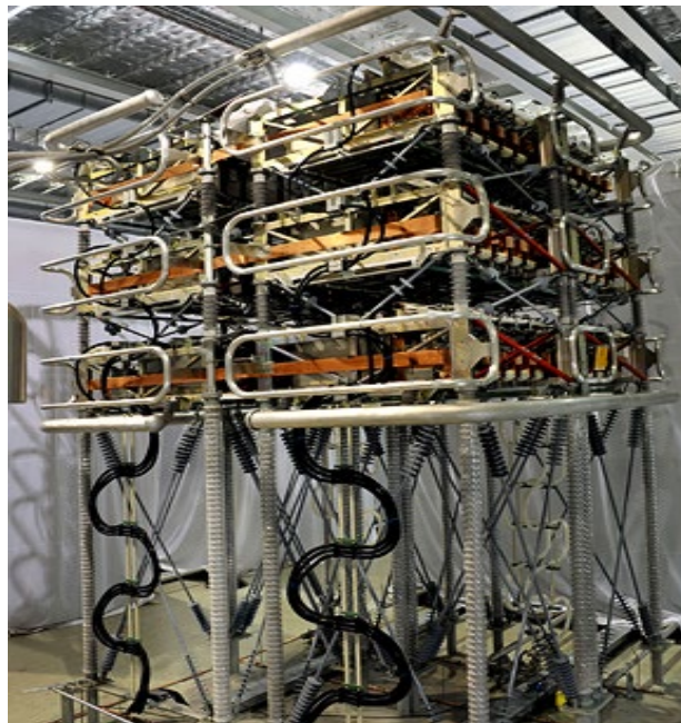
Figura 11 – Moduli di conversione.
