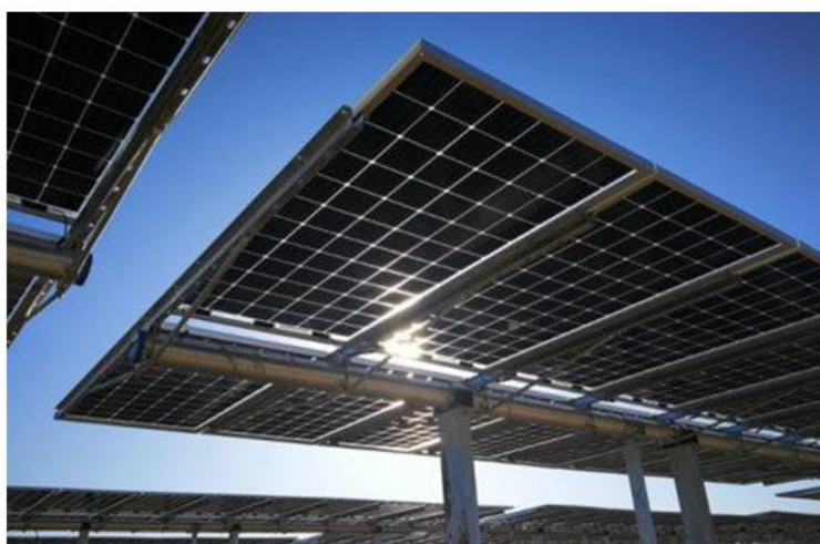
Figura 3.5: Particolare strutture di sostegno moduli
