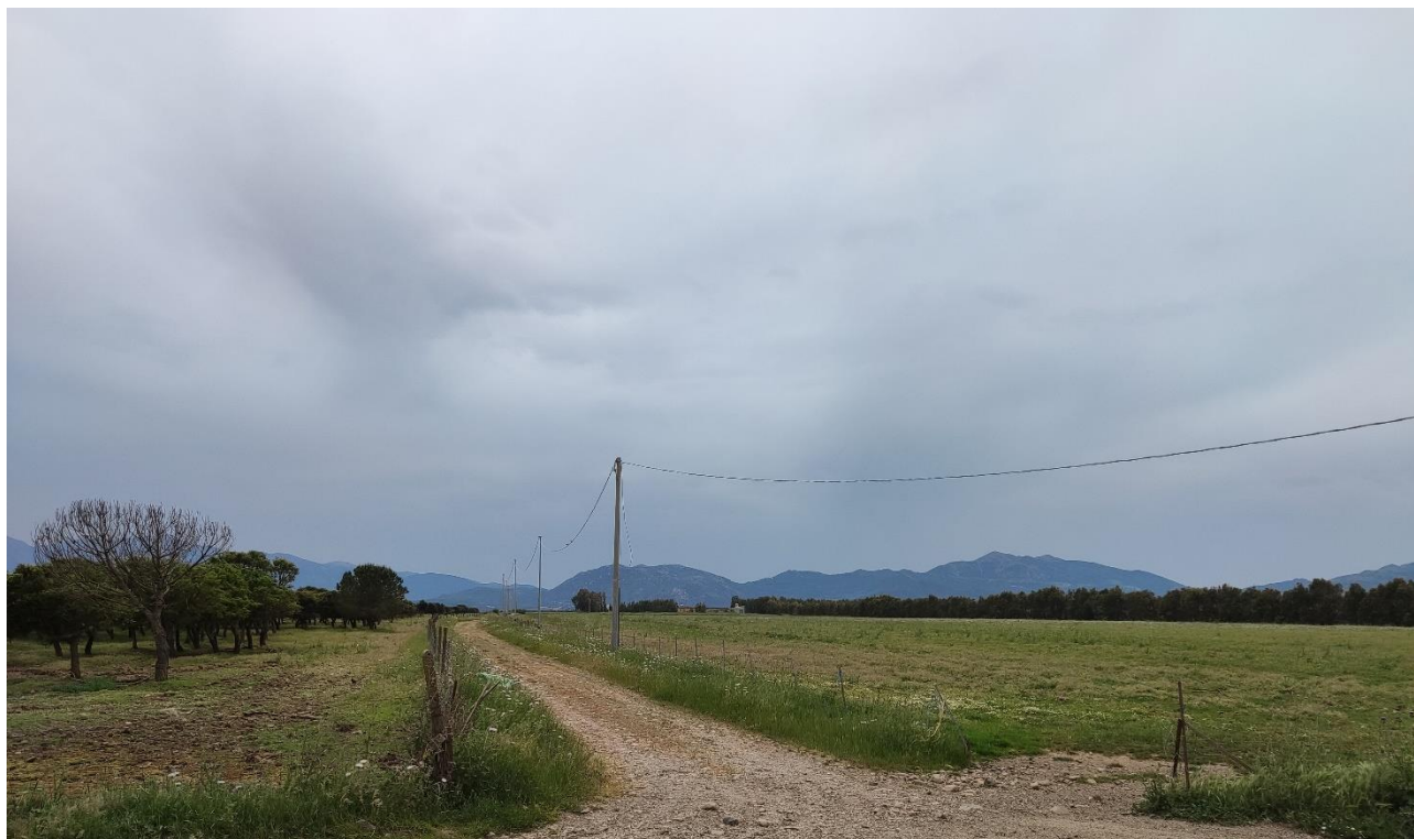
Figura 2.8: Linea aerea di bassa tensione su palo.
