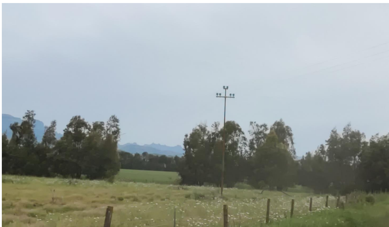
Figura 2.9: Linea aerea di media tensione su palo.
