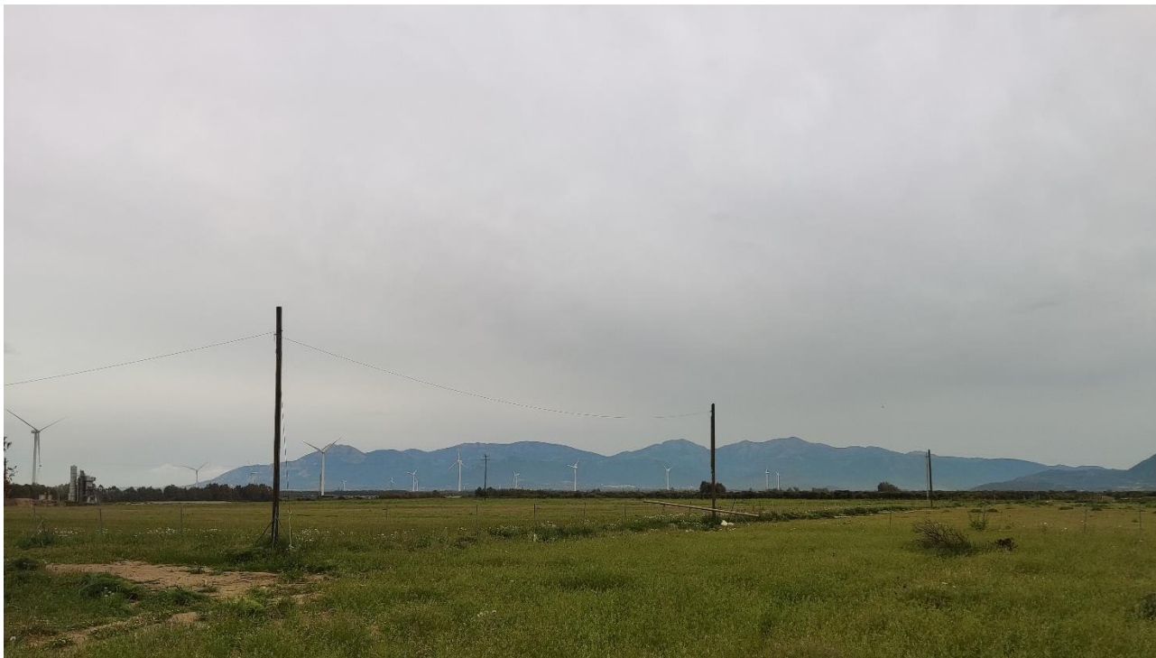
Figura 2.6: Linea aerea di telecomunicazione.
