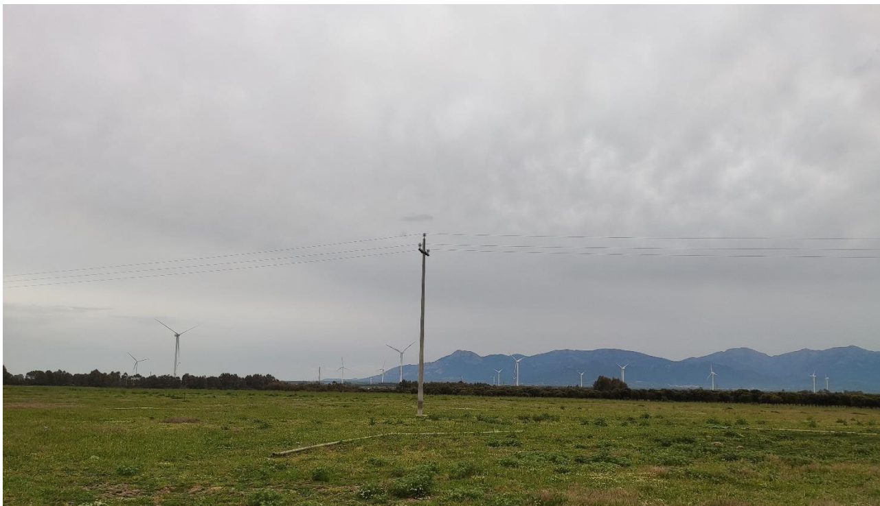
Figura 2.7: Linea aerea di media tensione su palo.
