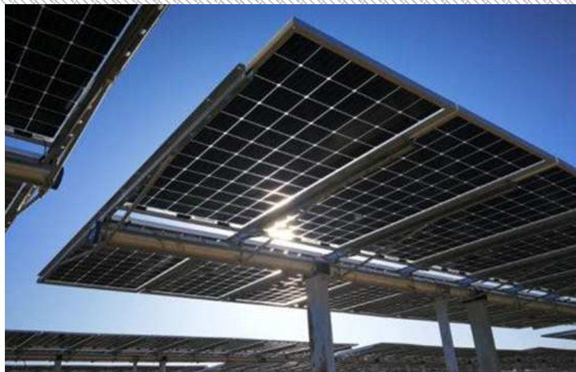
Figura 3.2: Particolare strutture di sostegno moduli
